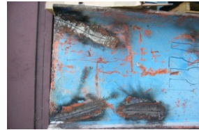
疲労亀裂の例
