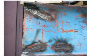
疲労亀裂の例
