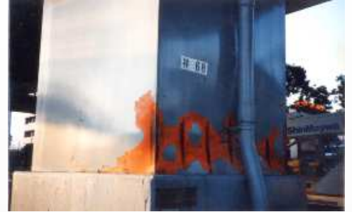
兵庫南部地震時の鋼製橋脚の座屈
