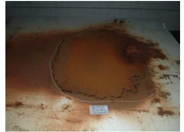
腐食状況の一例
