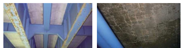
老朽化による損傷例(左:腐食, 右:ひび割れ)
