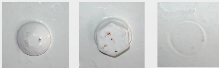
図 塗装後の状況比較
