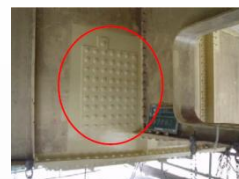
当て板補修の例 1)
