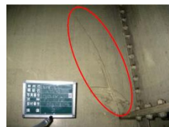
疲労亀裂の例 1)
