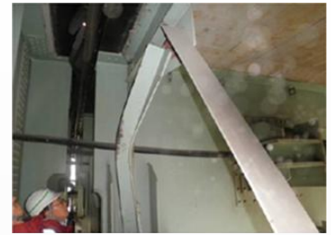
端対傾構斜材の座屈
